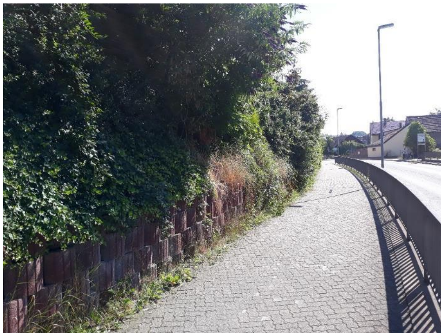
Foto 21: ... ist die Böschung durch Pflanzringe gestützt. Diese bieten hohes Habitatpotential für Reptilien.
