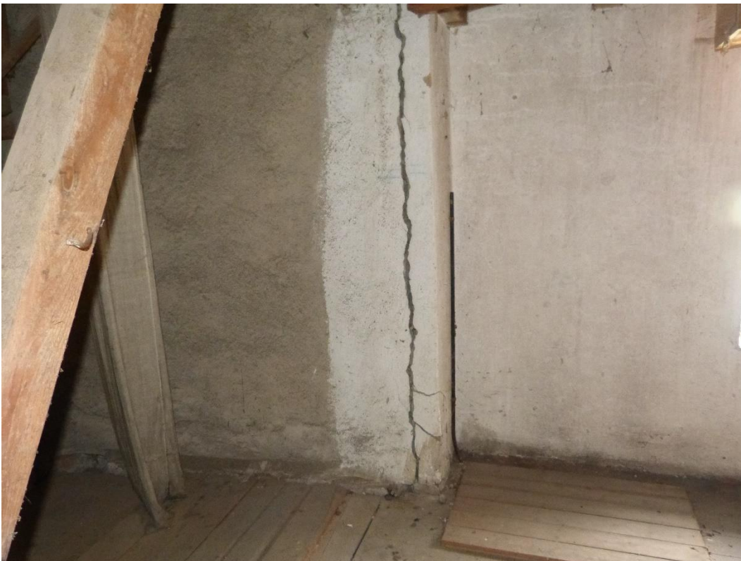
Bild 4: in einem Riss der Hauswand wurden ebenfalls geringe Mengen von Fledermauskot gefunden.
