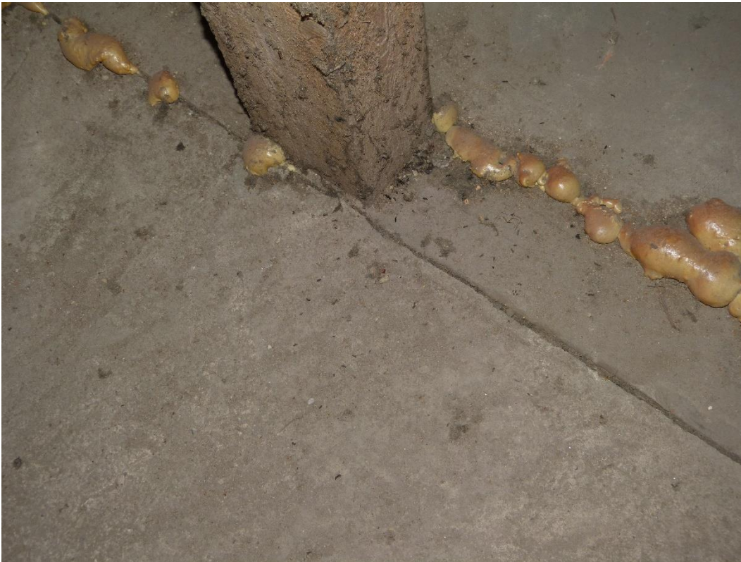
Bild 3: geringe Mengen an Fledermauskot einer kleinen Fledermausart unter einer Balkenkehle.
