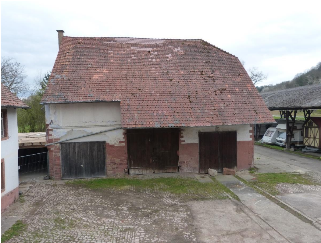
Bild 7: Blick auf die Scheune – in dem Gebäude waren keine Hinweise auf Fledermäuse / Vögel nachweisbar
