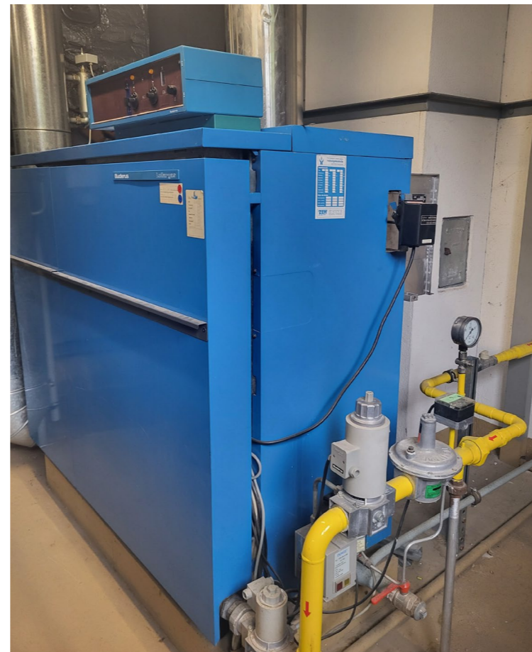
Veraltete Anlagentechnik mit hohem Energieverbrauch und CO 2 -Ausstoß
