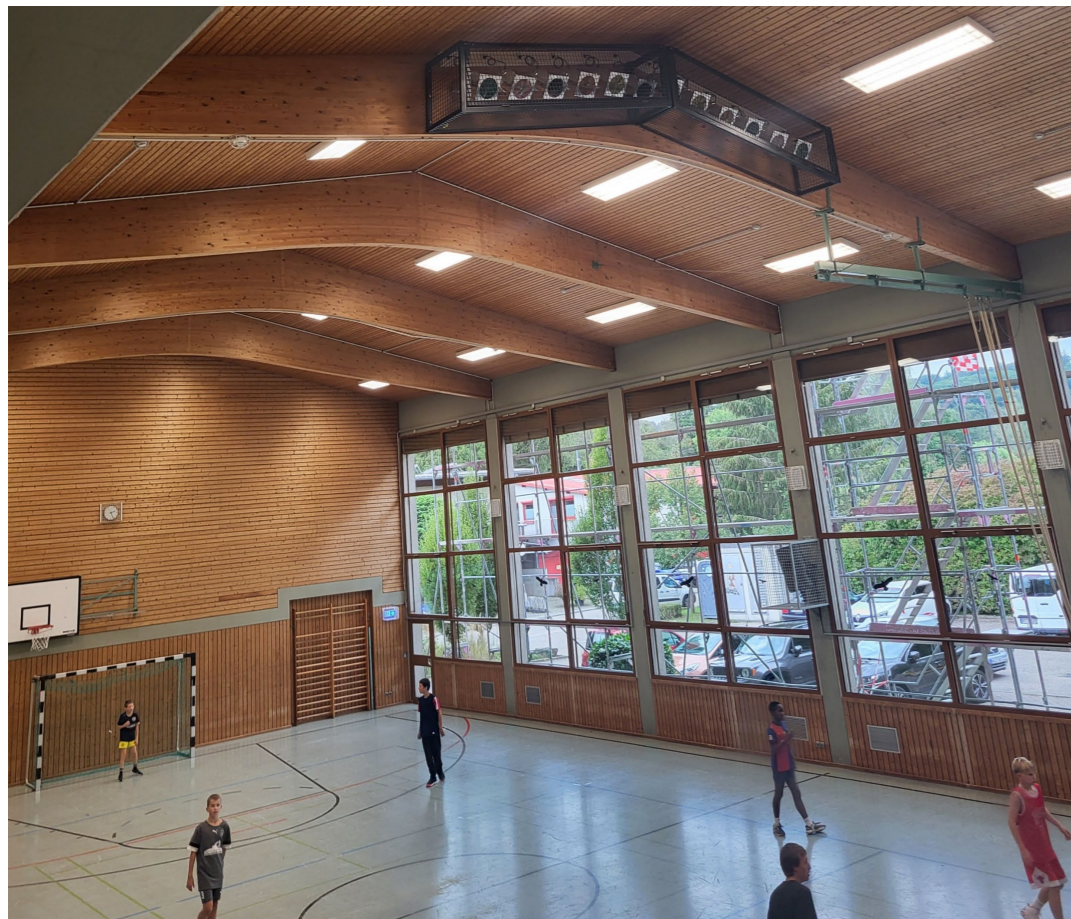
Große Fensterfronten mit hohem Wärmeverlust, Erneuerung Hallenboden erforderlich
