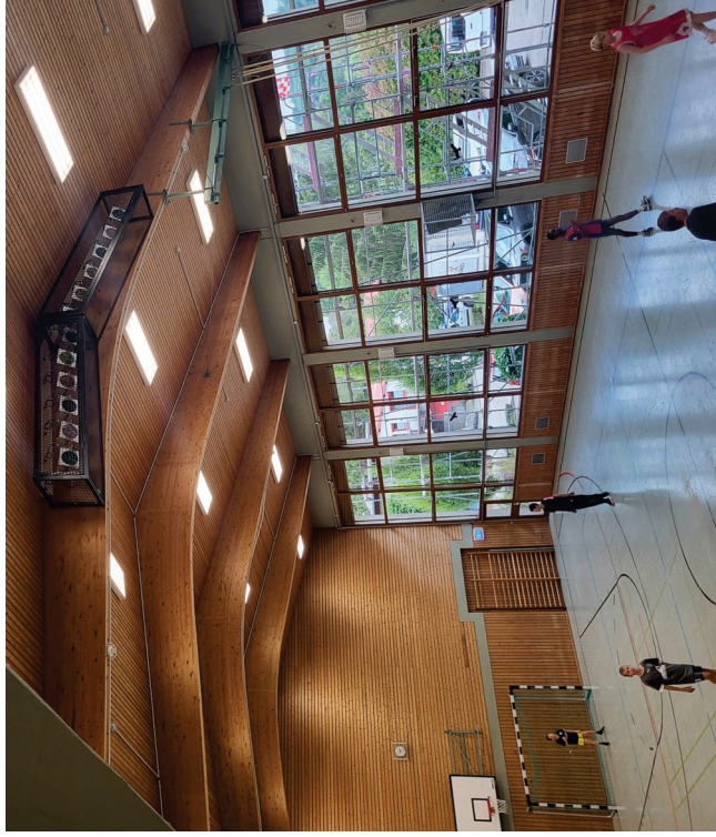
Große Fensterfronten mit hohem Wärmeverlust, Erneuerung Hallenboden erforderlich
