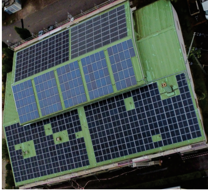
180 kWp bieten gute Voraussetzung für nachhaltige Wärmeerzeugung über Wärmepumpe
