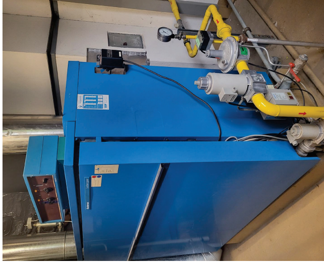
Veraltete Anlagentechnik mit hohem Energieverbrauch und CO 2 -Ausstoß
